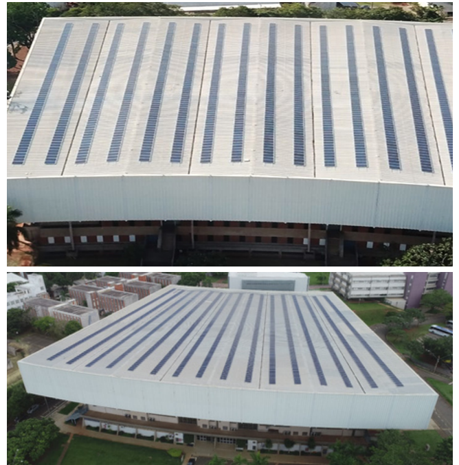
Fig. 2. Usina Fotovoltaica instalada na UNICAMP.
